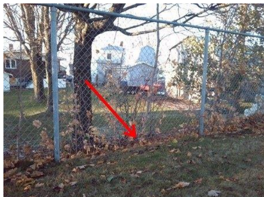
La clôture doit être abaissée pour éliminer l'espace de 100 mm.
