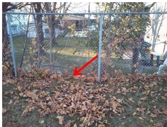
Espaces de plus de 100 mm sous la clôture.
